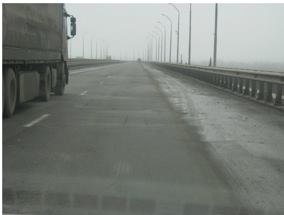
Рис. 32. Образование неровностей на проезжей части сталебетонного моста при использовании рулонной гидроизоляции «Мостопласт»
