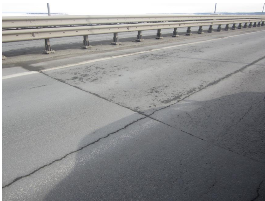
Рис. 24. Состояние покрытия на левобережной части моста
