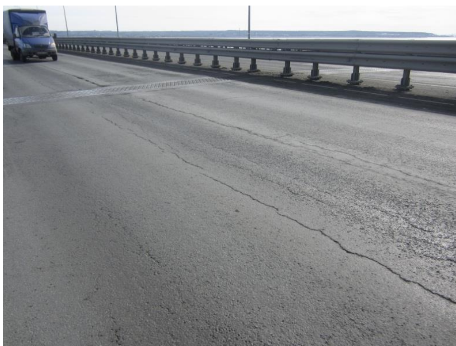
Рис. 28. Состояние покрытия на правобережной части моста
