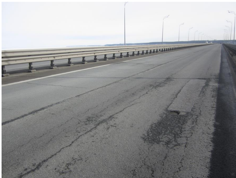
Рис. 25. Состояние покрытия на левобережной части моста
