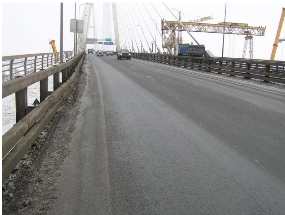
Рис. 21. продольная трещина над ребром коробчатой балки пролетного строения
