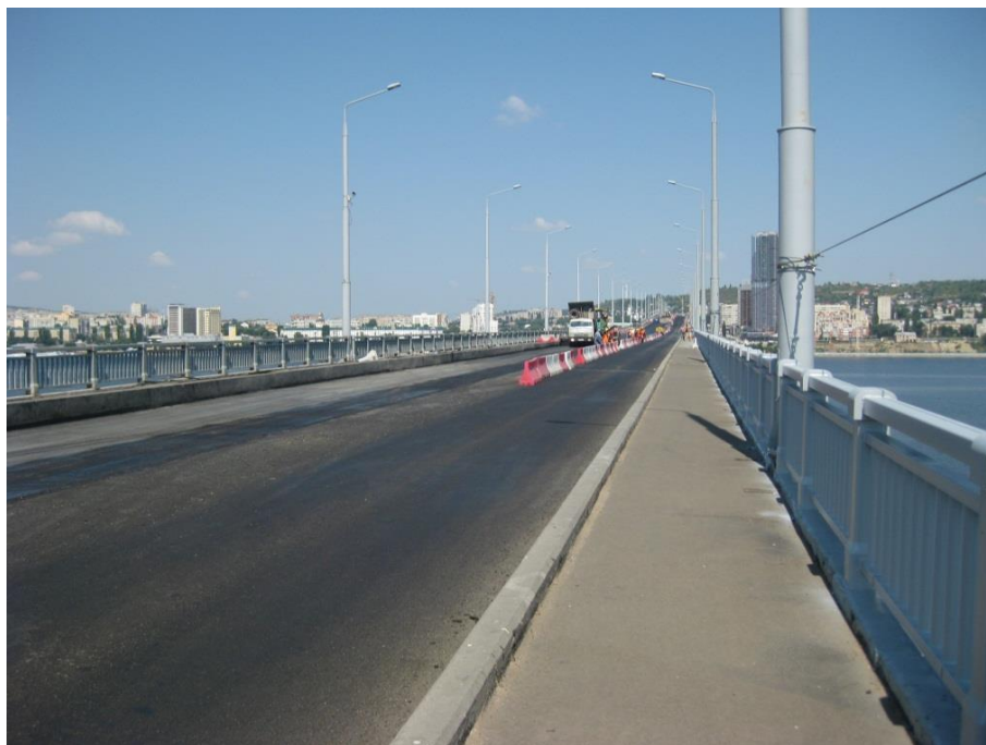
Рис. 19. участок моста с полностью уложенной дорожной одеждой по всей ширине проезжей части
