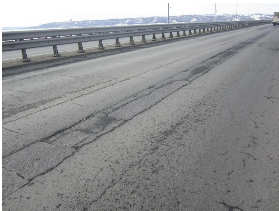
Рис. 26. Состояние покрытия на левобережной части моста
