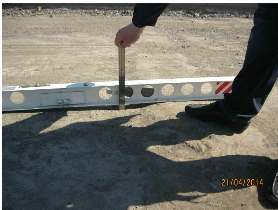
Рис. 8. Состояние плиты проезжей части после снятия дорожной одежды
