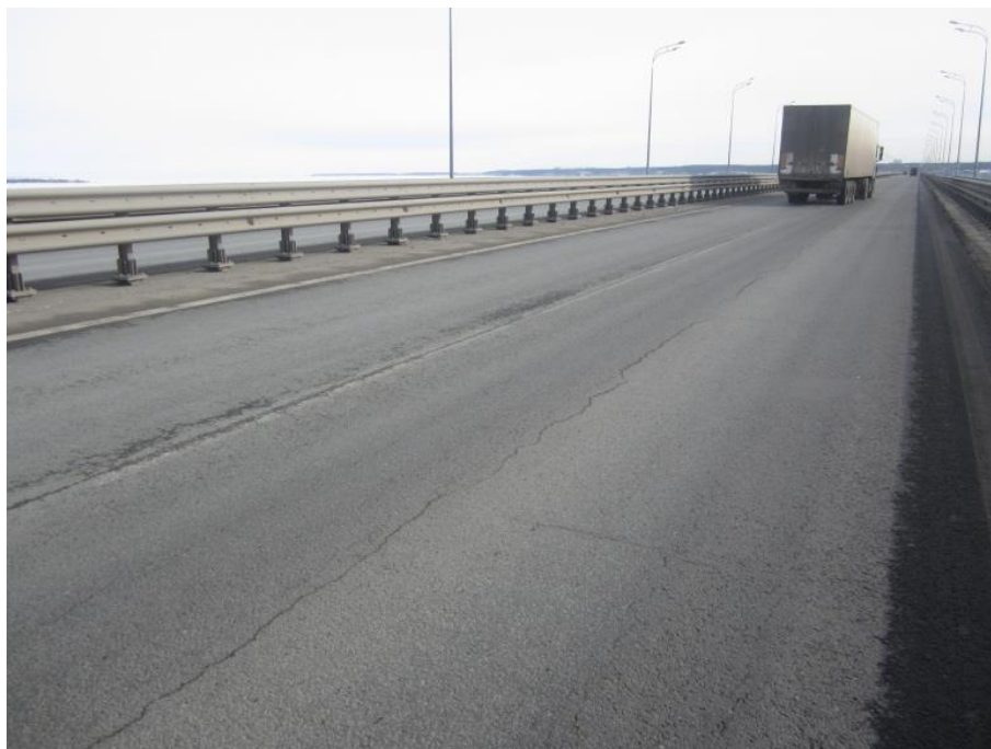
Рис. 27. Состояние покрытия на правобережной части моста
