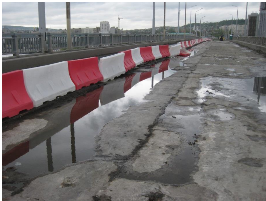
Рис. 10. Состояние плиты проезжей части после снятия дорожной одежды
