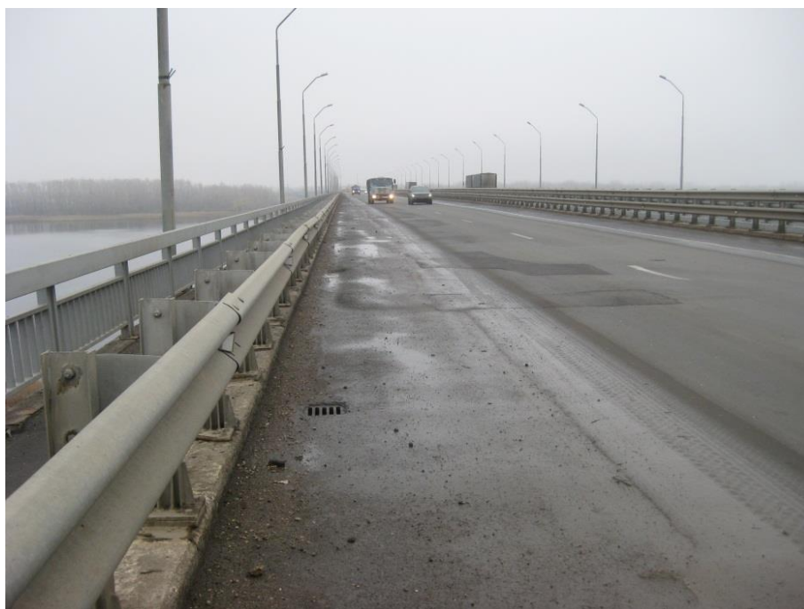
Рис. 33. Образование вмятин и пузырей на проезжей части моста
