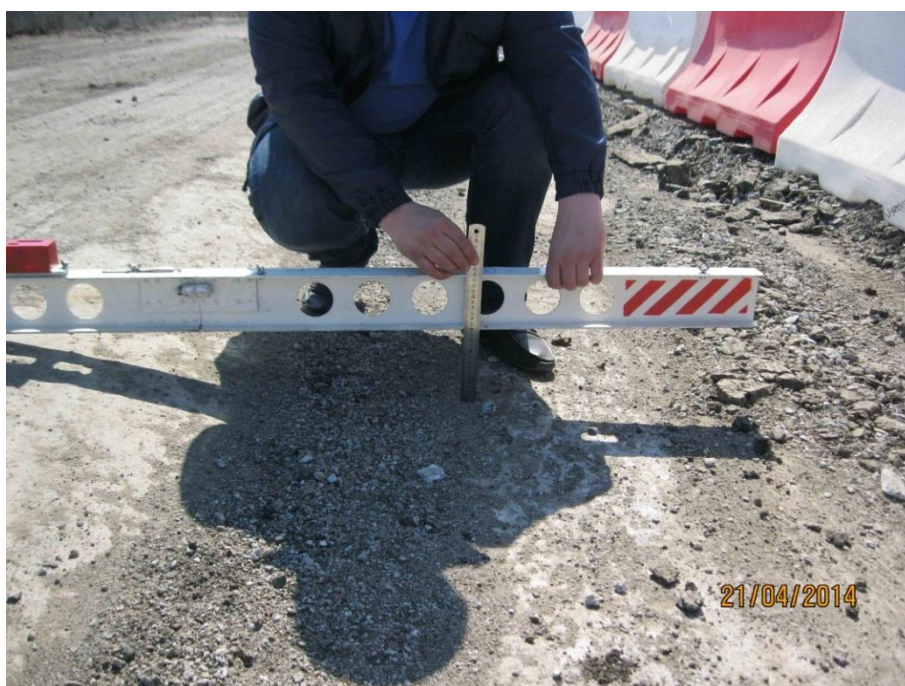
Рис. 6. Состояние плиты проезжей части после снятия дорожной одежды
