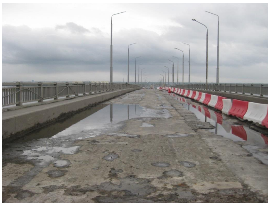
Рис. 11. Состояние плиты проезжей части после снятия дорожной одежды
