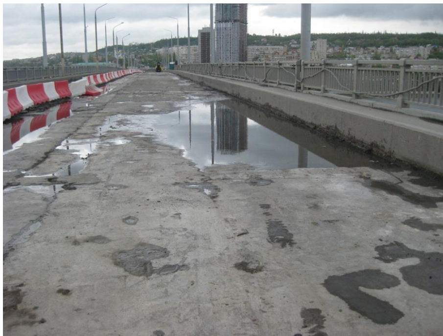
Рис. 9. Состояние плиты проезжей части после снятия дорожной одежды
