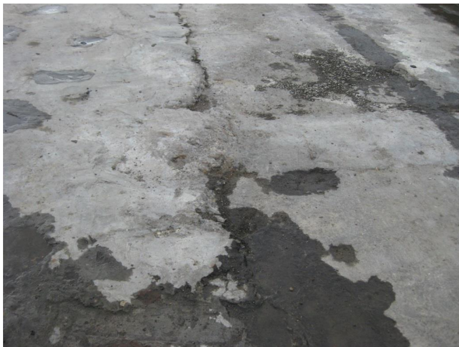
Рис. 7. Состояние плиты проезжей части после снятия дорожной одежды
