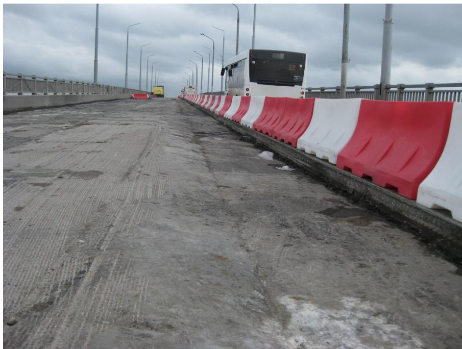
Рис. 5. Состояние плиты проезжей части после снятия дорожной одежды
