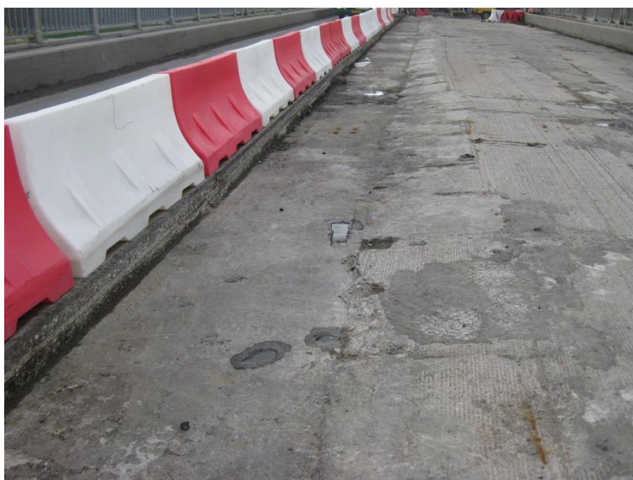
Рис. 4. Состояние плиты проезжей части после снятия дорожной одежды
