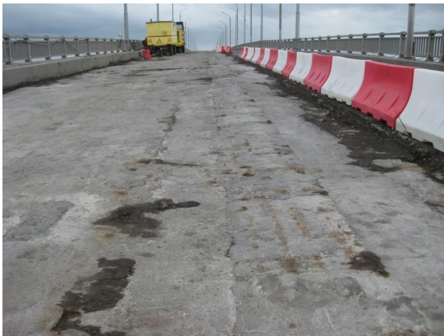
Рис. 3. Состояние плиты проезжей части после снятия дорожной одежды
