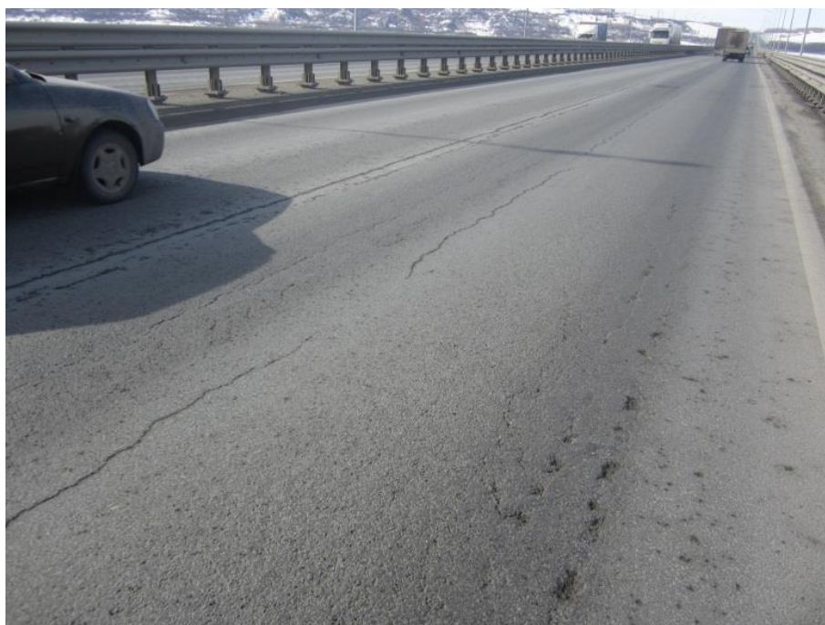
Рис. 29. Состояние покрытия на правобережной части моста
