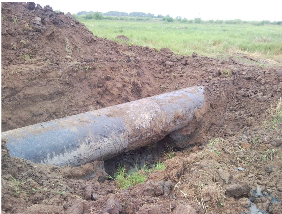
Рисунок 3. Контрольный шурф на нефтепроводе УБКУА, выполненный по результатам диагностического обследования
