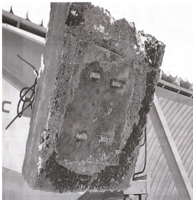
Рисунок 4. Разрыв анкерных стержней опорной пластины в месте изгиба (разработано автором)
