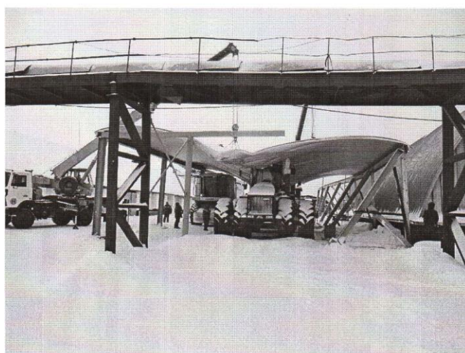
Рисунок 6. Общий вид на навес арочного типа, после обрушения (разработано автором)
