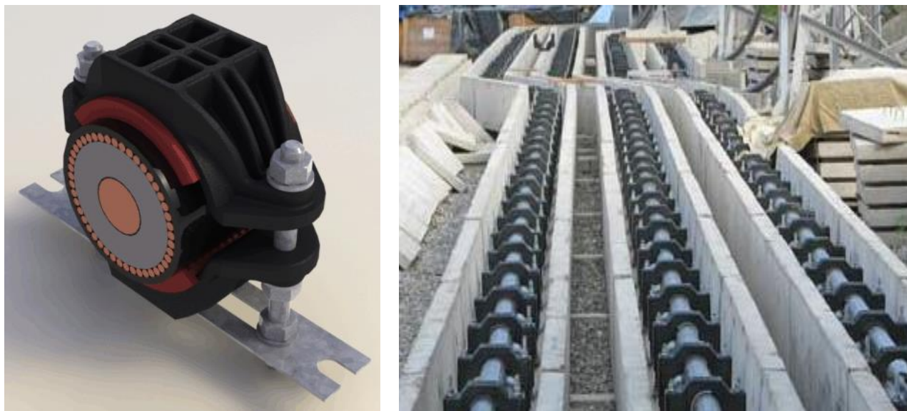
Рис. 16. Конструкция кабеля и кабельная линия 330 кВ, проложенная в каналах
