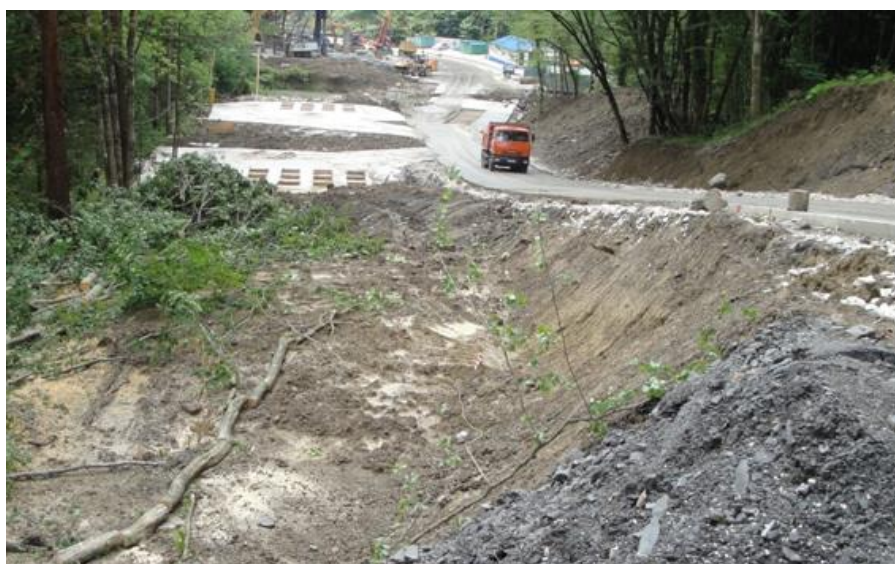
Рис. 1. Оползневой склон с устроенными фундаментами опор эстакад (разработано автором)
