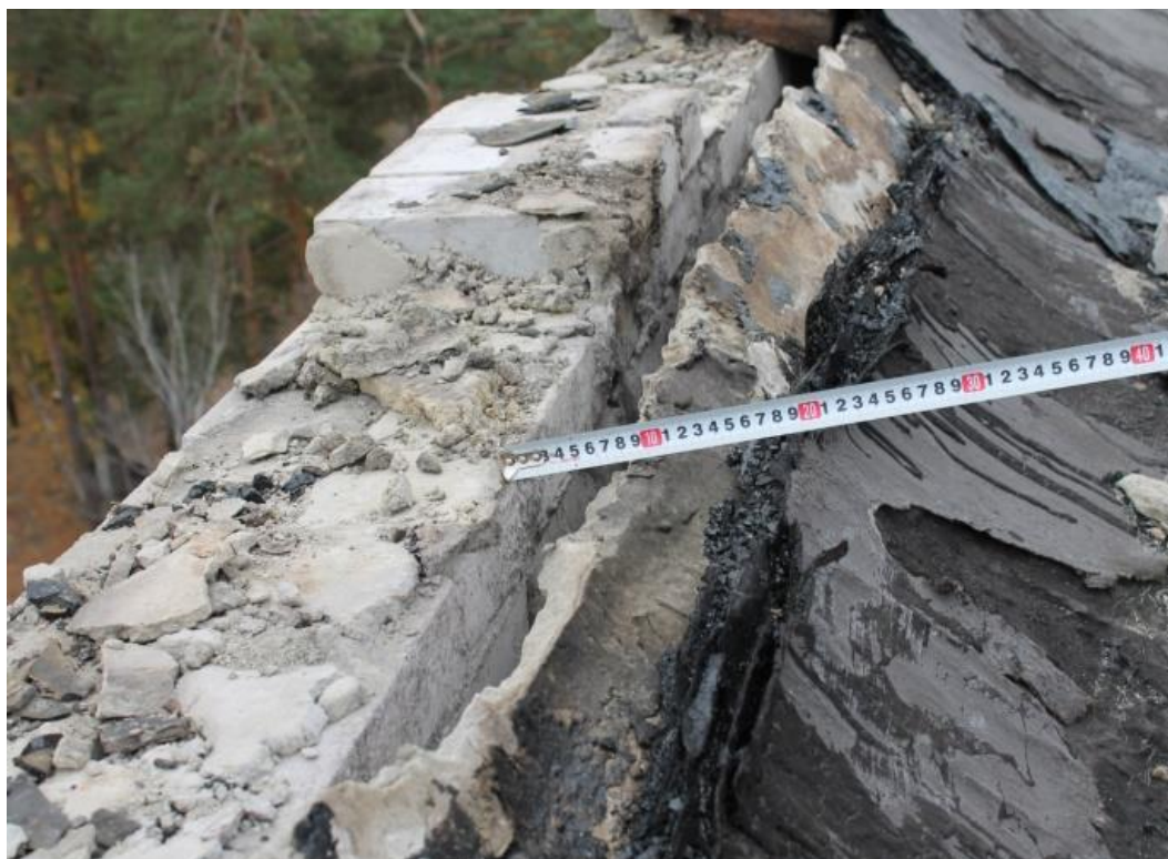
Рисунок 2. Верх стены отошел от перекрытия на 9 см (фото авторов)
