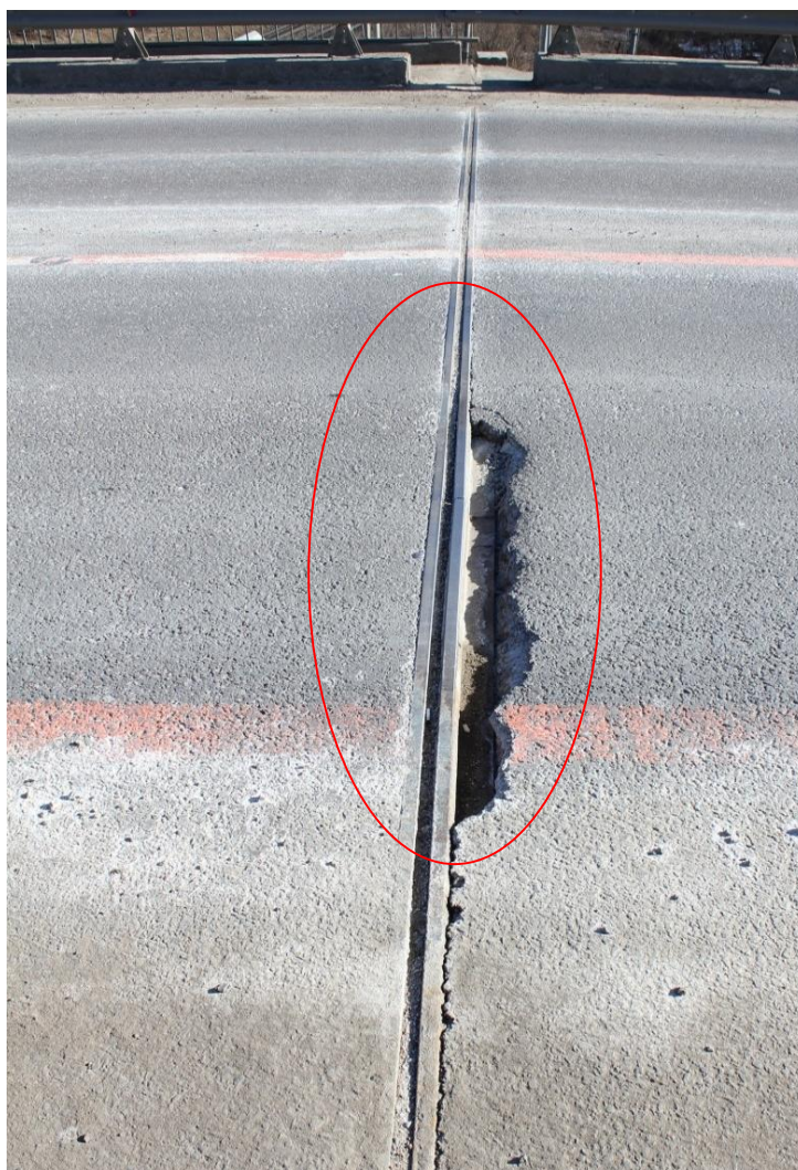
Рис. 2. Разрушение секции крайнего несущего профиля деформационного шва и верхнего слоя асфальтобетонного покрытия околошовной зоны (спустя 10 месяцев после ввода сооружения в эксплуатацию).
