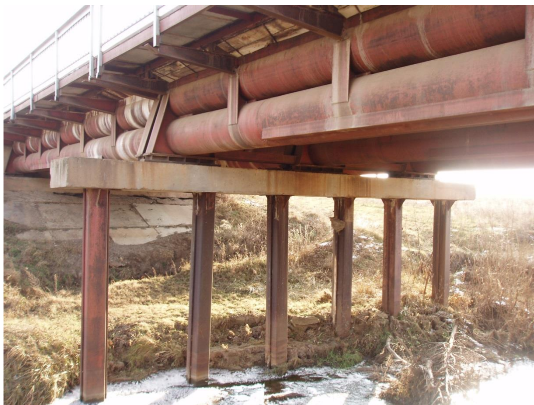
Рис. 13. Общий вид моста через реку Мишуга у н.п. Атрякле на автомобильной дороге Нов. Айманово – Атрякле – Калтаково – Филимоновка
