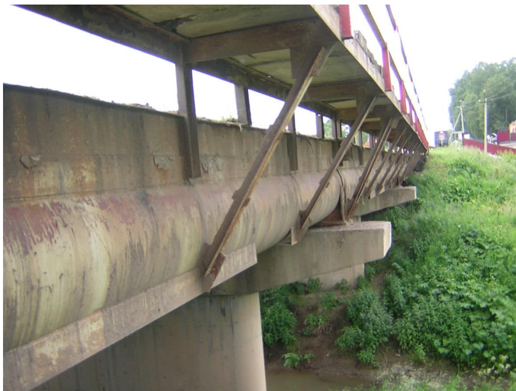
Рис. 3. Многопролетный неразрезной трубчатый мост на автодороге Казань - Киров км 104+752
