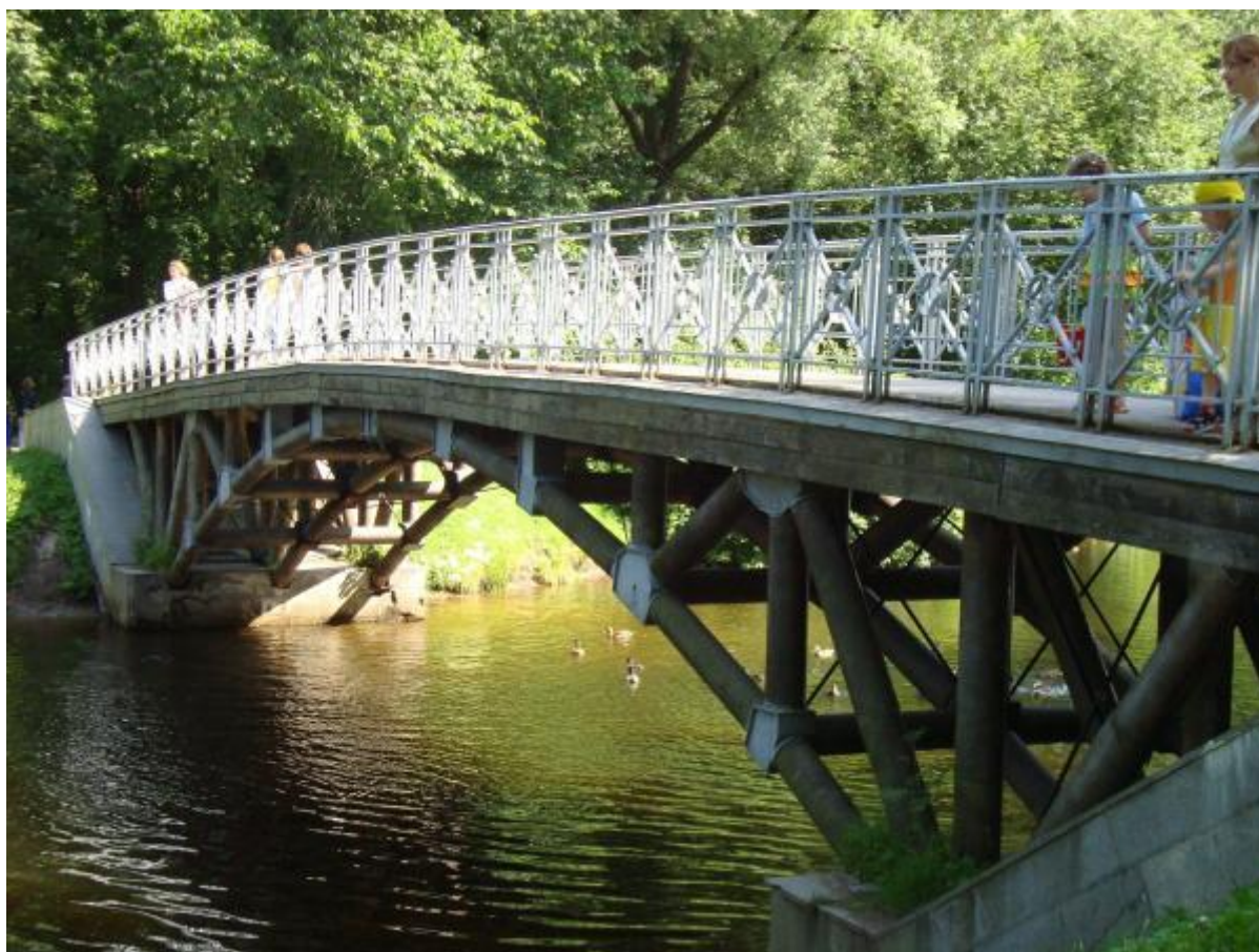
Рис. 1. Мост с несущими элементами из фанерных труб конструкции А.М. Димова. Источник: http://wikimapia.org/14138780/ru/Пешеходный-мост
