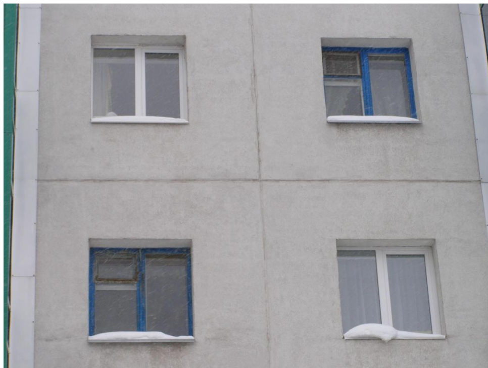
Рис. 2. Состояние СФТК после 18 лет эксплуатации в хорошем состоянии
