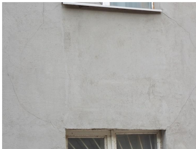
Рис. 5. Диагональные трещины в углах оконных зон, с раскрытием до 4 мм и длиной более 1 метра
