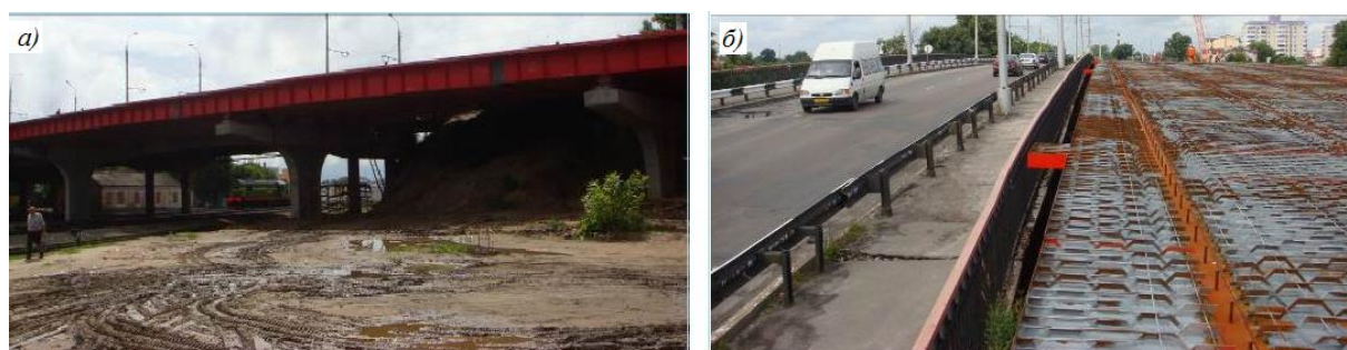
Рис. 4. Путепровод (первая очередь) по ул. Полесской в г. Гомеле (2011 г.): общий вид путепровода (а) и фрагмент мостового полотна на этапе монтажа (б)
