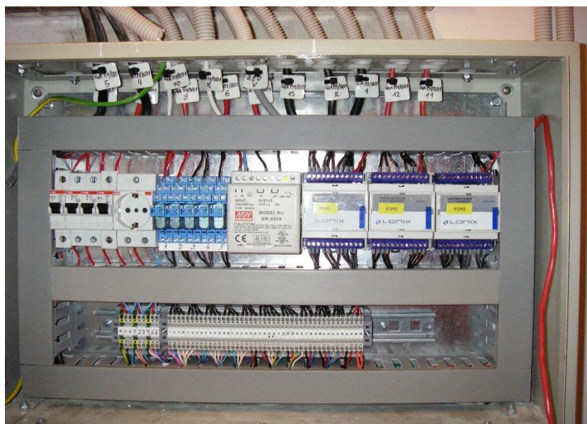
Рис. 7. Исправленный монтаж щита управления
