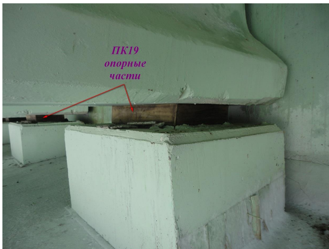
Рис. 3. Мост через ручей Голубки км 298+318. Деформация резиновых опорных частей
