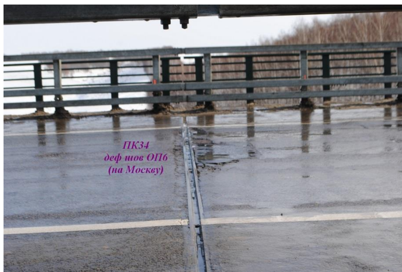
Рис. 5. Разрушение покрытия проезжей части в околошовной зоне. Мост км 300
