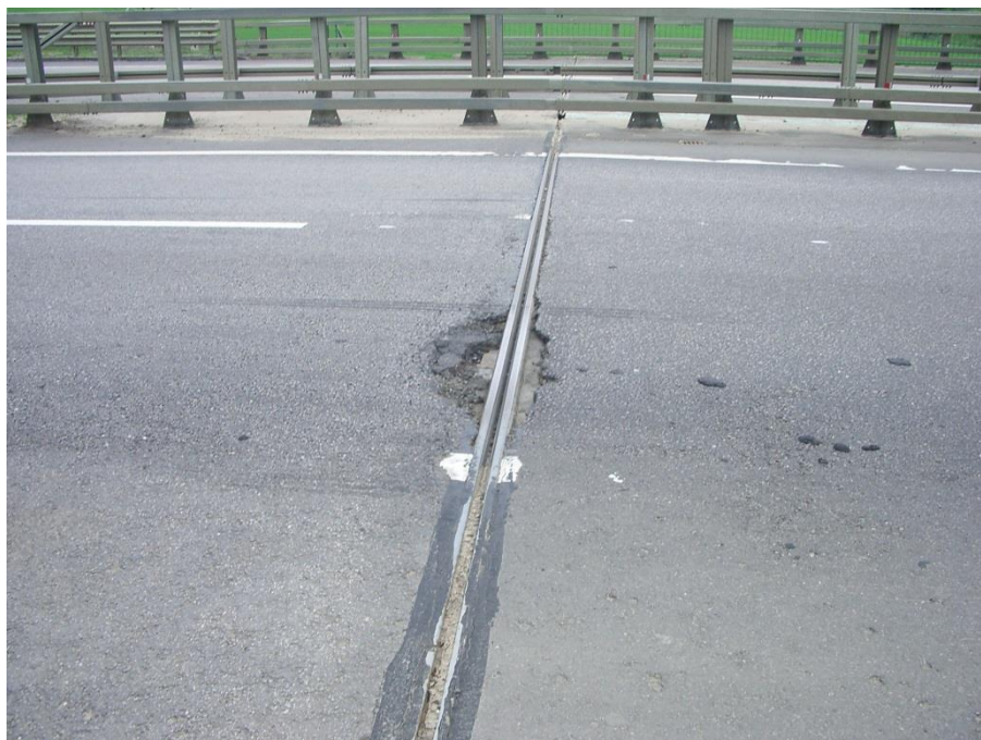
Рис. 1. Начальный этап разрушения (мост через ручей Голубки км 298+318)
