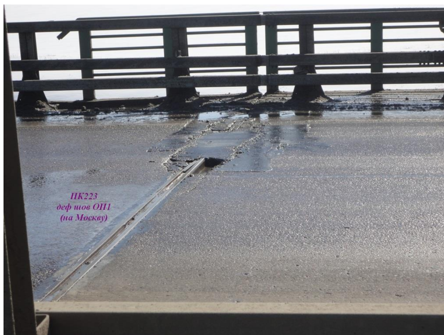
Рис. 4. Разрушение покрытия по полосе наката. Мост на км 318+784
